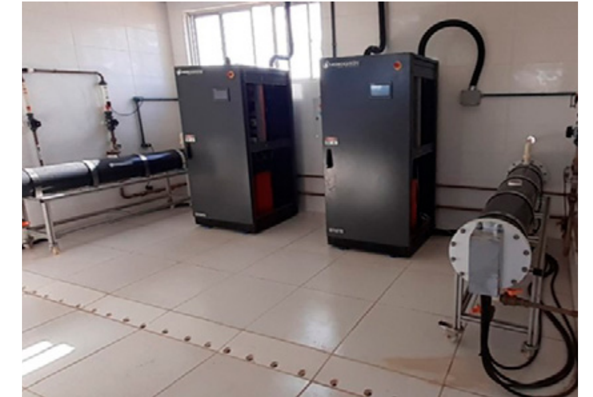
Novo sistema de gerador de hipoclorito
