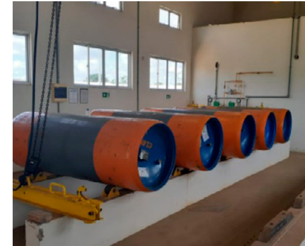
Sistema antigo de gás cloro
