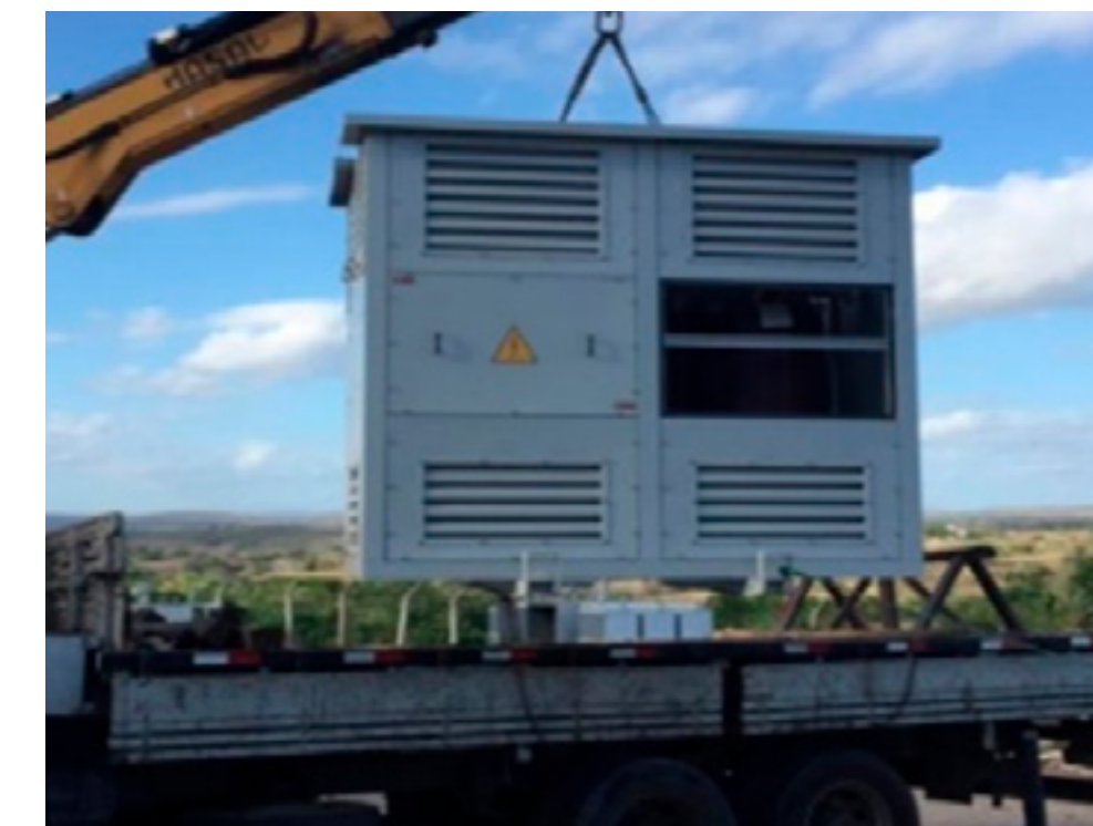
Novo transformador da EEAT 02
