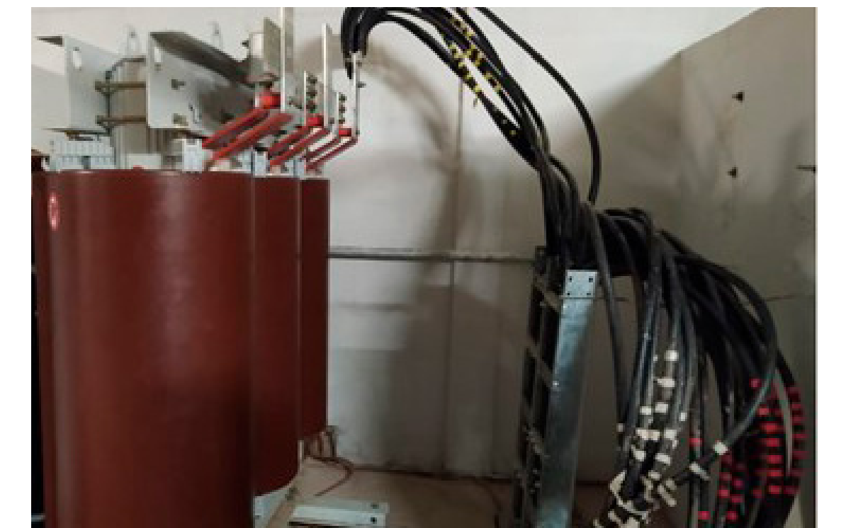
Novo Transformador da captação Traipu
